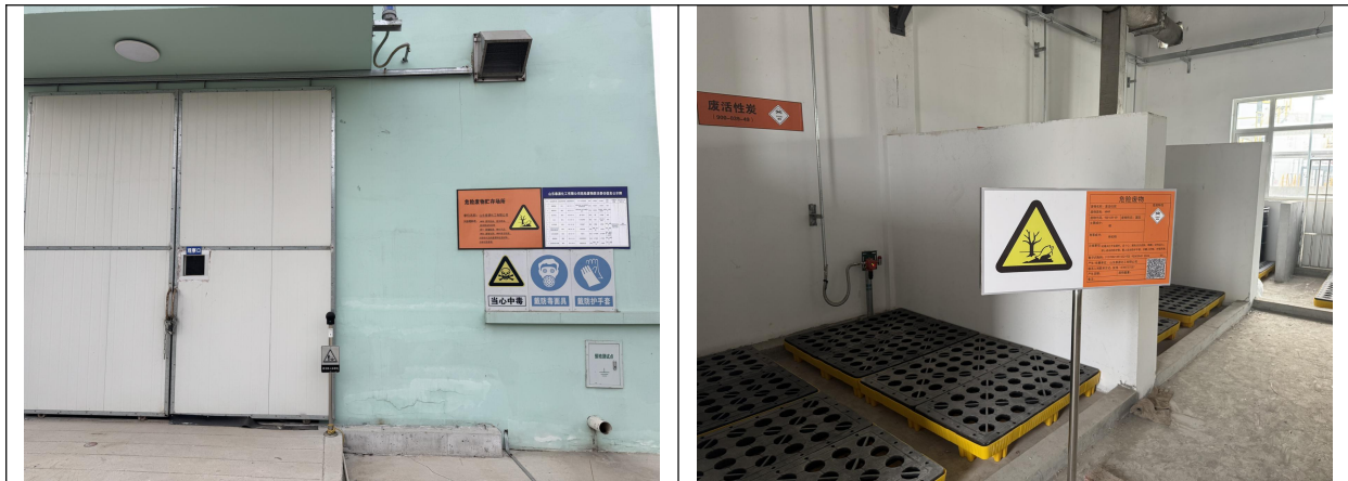
危险废物暂存间照片
